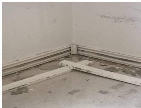
Plinthes non jointives et goulottes électriques
