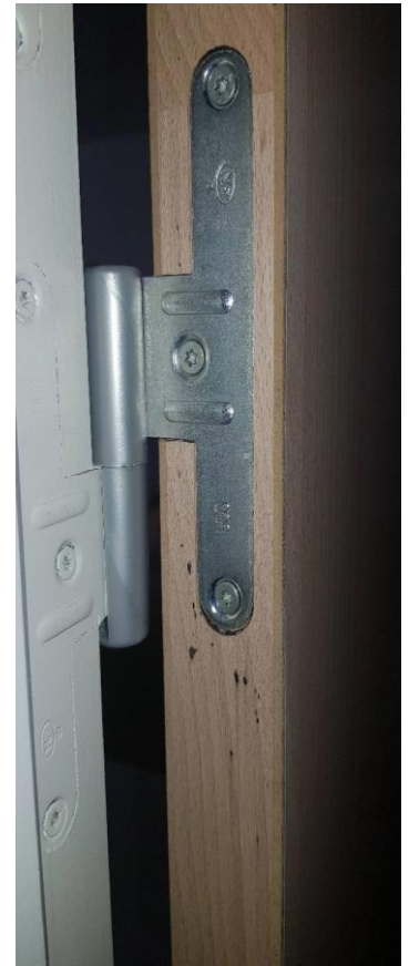
Champ d'une porte de chambre d'Ehpad
