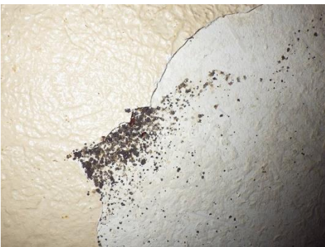
Dévoilées derrière un enduit décollé du mur
